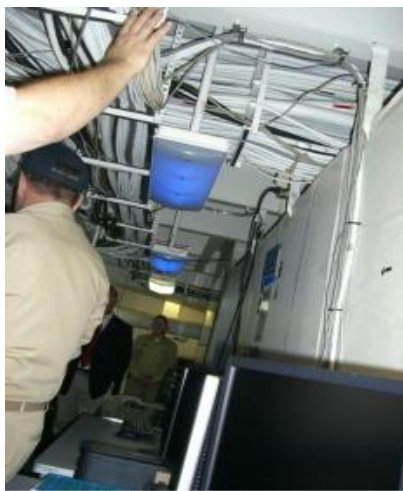
熱により大量の配線類がダメージを受けた
